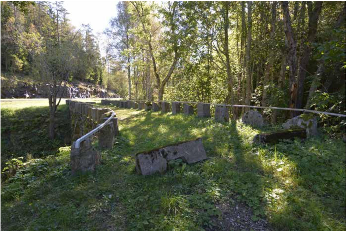
Dekket over brua er i dag tilgrodd med gress.
