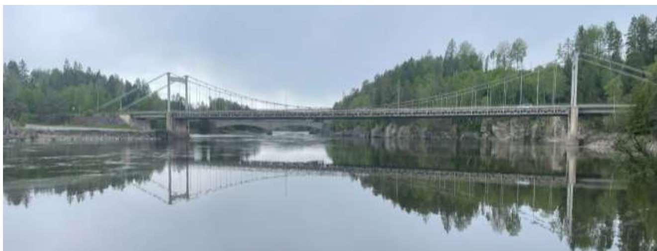
Figur 10-4 Dagens bru sett fra nordøst. Skogdekte koller og skråninger rammer inn elvelandskapet. (Foto: Grindaker)
