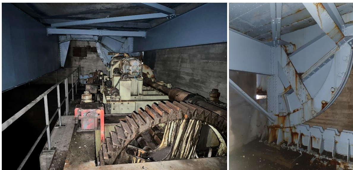
Figur 4-29 Mekanikken fra eksisterende klaffebru i maskinrommet under kanalbrua på østsiden. Foto Norconsult våren 2023.
