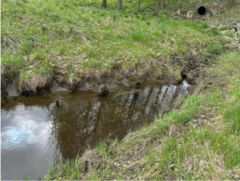
Figur 5-9: Bilde på erosjonsbefaring. Noe erosjon. Bilde tatt ved lokalt rør på Tarris og i området hvor det tidligere eksisterte en tømmerrenne. Foto: Multiconsult.
