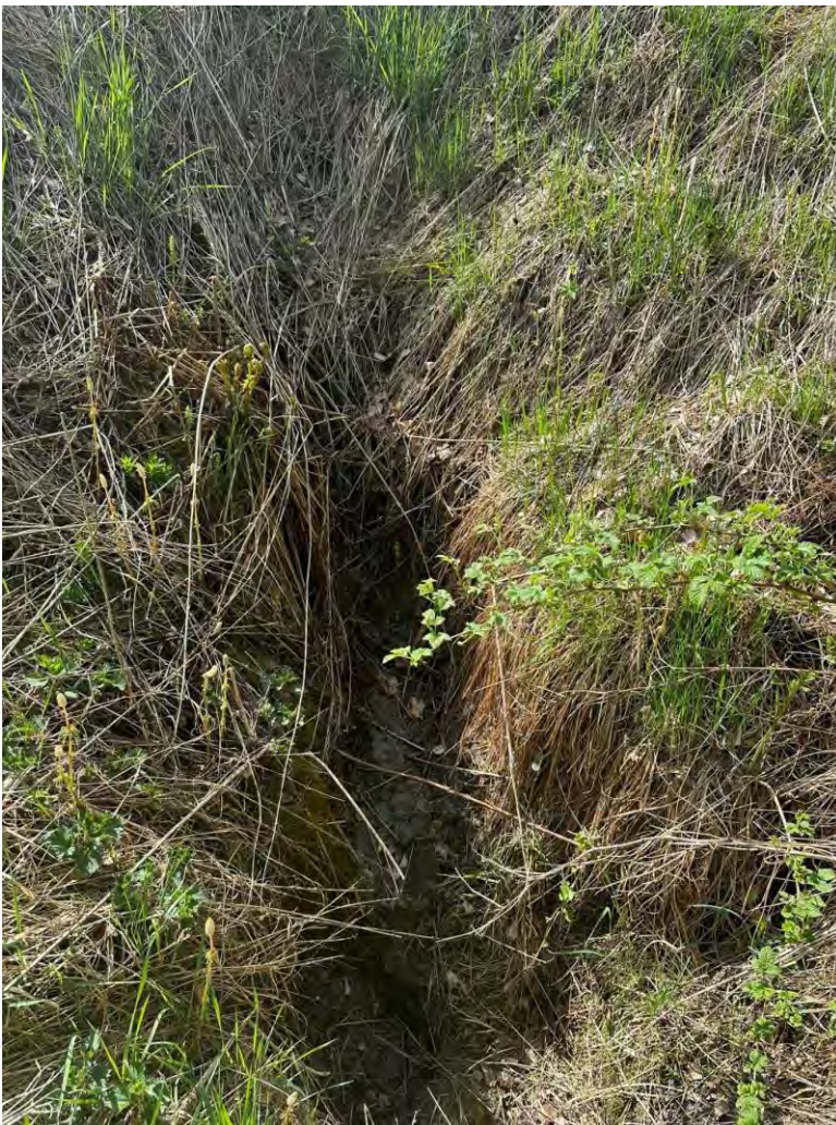
Figur 5-9: Bilde tatt på erosjonsbefaring. Litt erosjon. Foto: Multiconsult.
